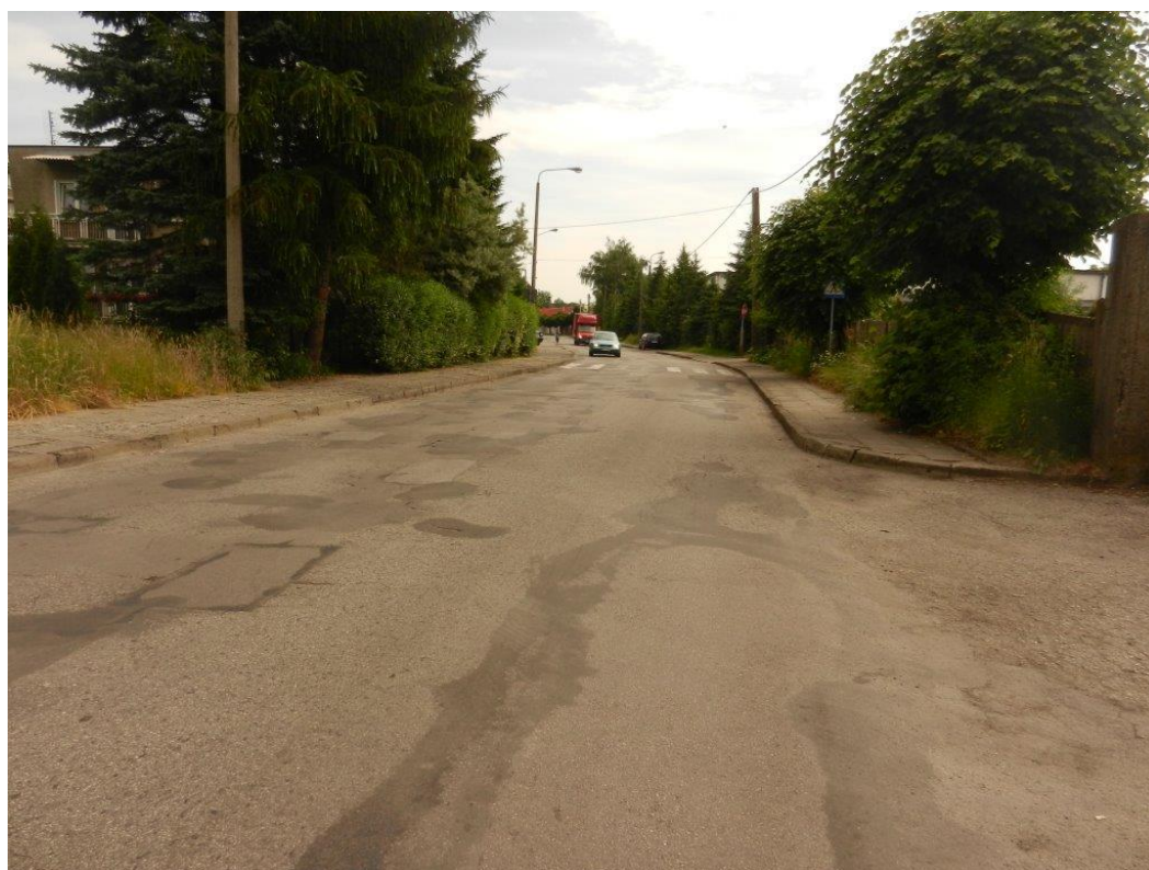
Wymagająca remontu ulica Górny Bór
