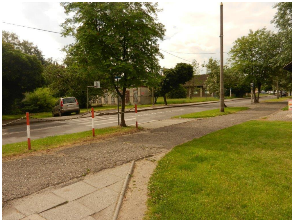
Wymagająca remontu ulica Górny Bór
