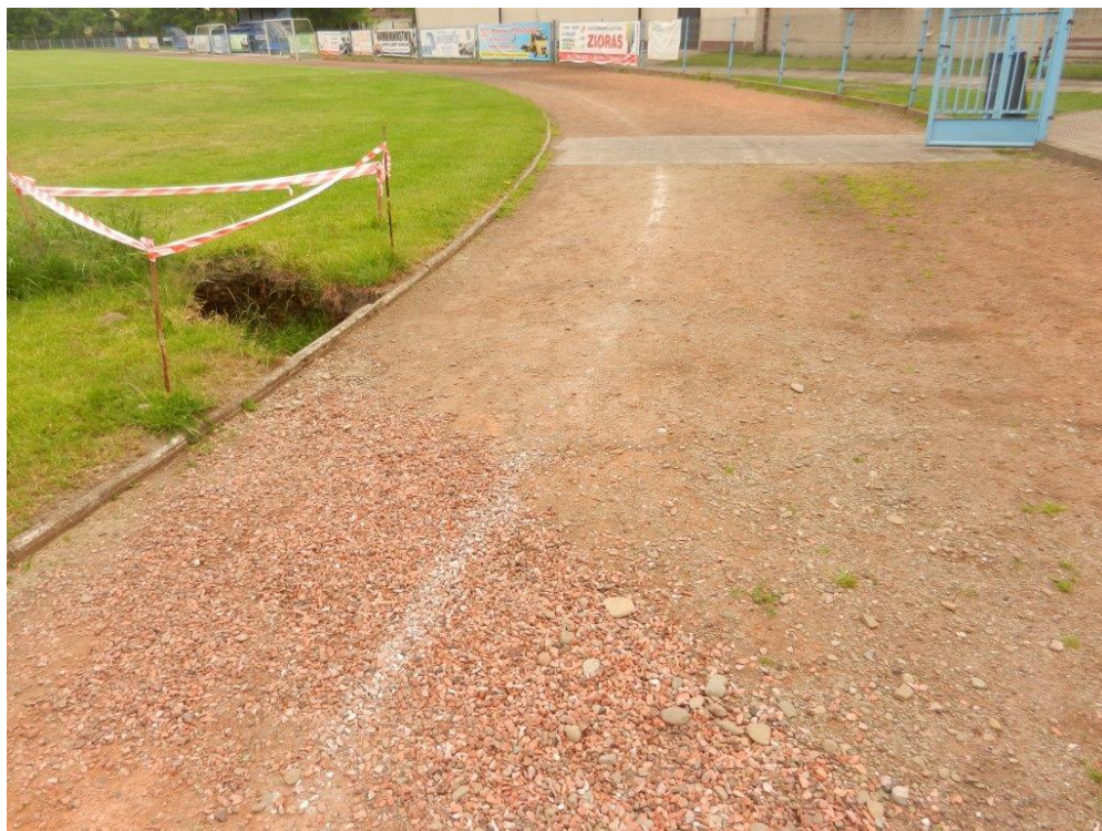
Zniszczona bieżnia Stadionu Miejskiego
