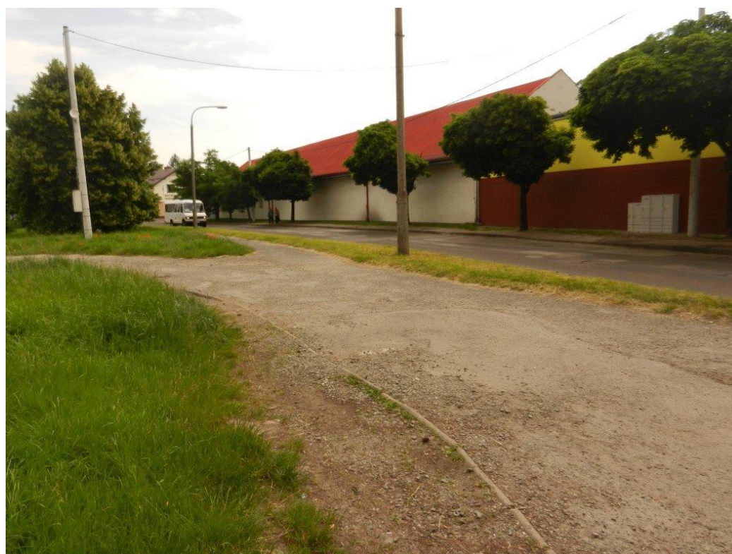
Wymagająca remontu ulica Górny Bór
