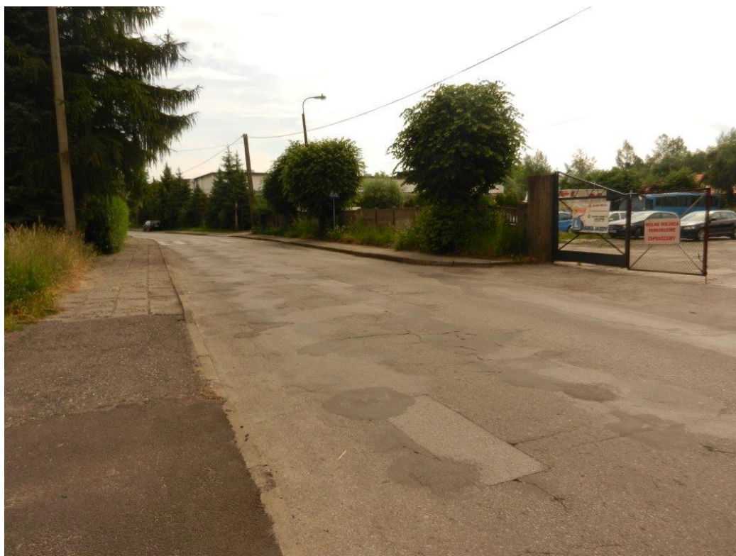
Wymagająca remontu ulica Górny Bór
