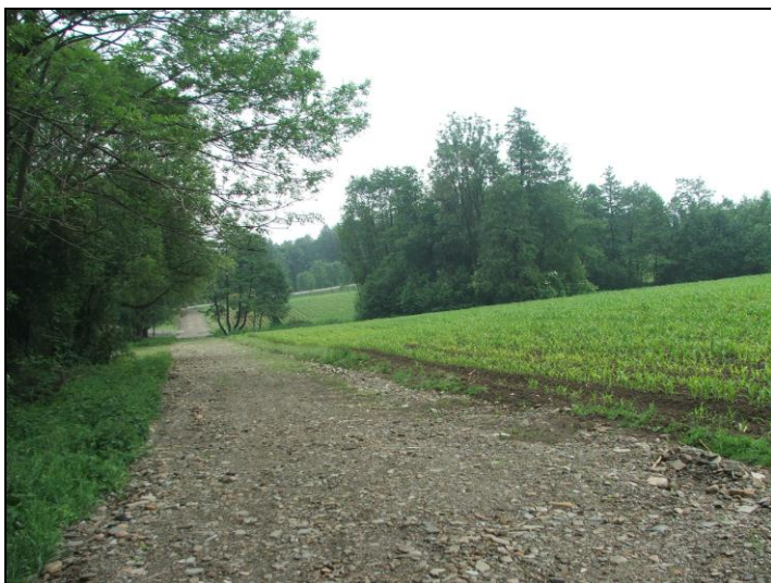
Fot. 2 Zrealizowana droga, widok w kierunku południowym, po stronie zachodniej teren 3MW
